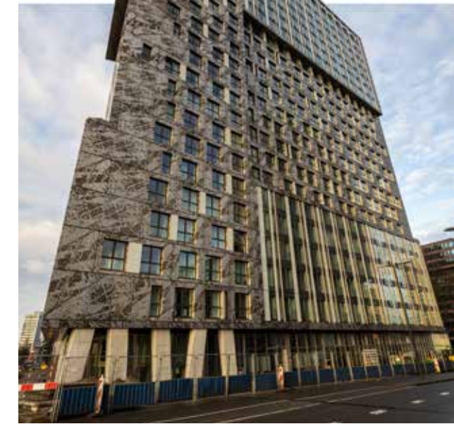
De kracht van Intal: de combinatie tussen grote aantallen sterk repeterende kozijnen in prefab, met complexe engineering in een vliesgevel voor de plint. (Beeld: Sebastiaan Rozendaal)
